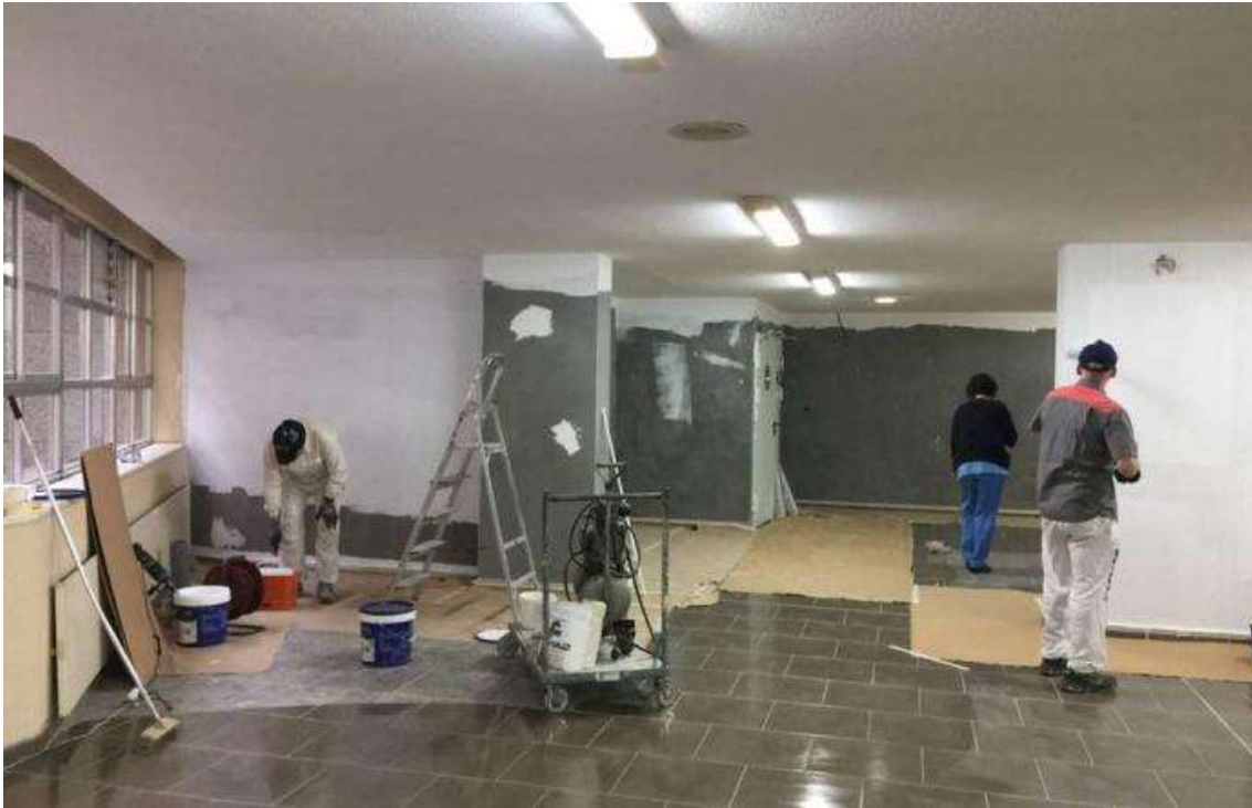
Trabajadores del ERA pintan las paredes afectadas por la obra, que el Principado sostiene que habían sido pintadas por la empresa adjudicataria de la reforma.
